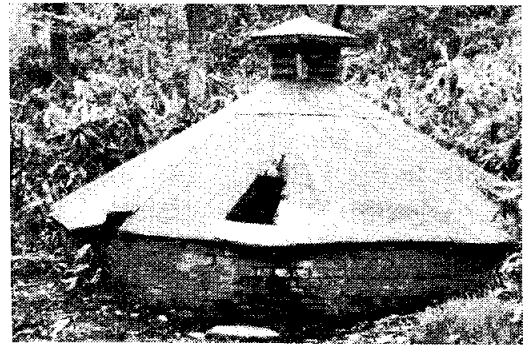
私設水道組合貯水槽
