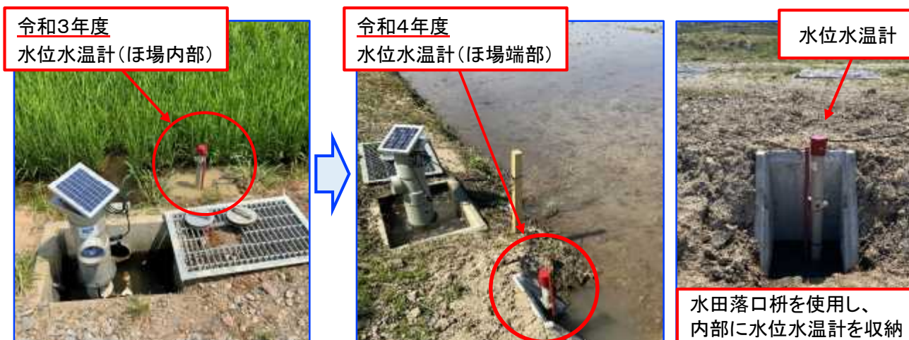
図 16. 水位水温計の設置状況（令和3年度・令和4年度比較）
