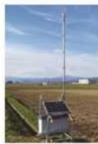
▲ソーラーパネルユニットと通信中継機
