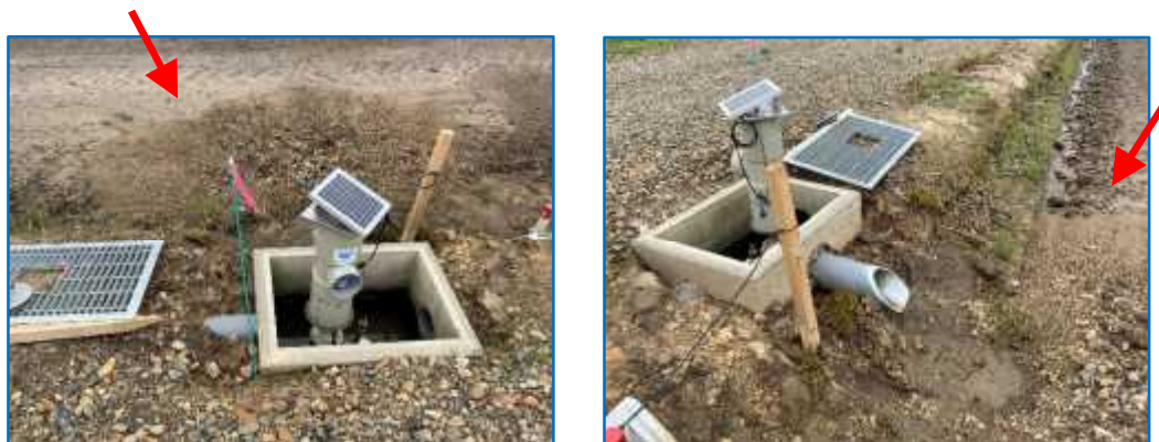
図 35. 給水栓柵周辺の土砂がほ場に流出した状況（矢印部分）
