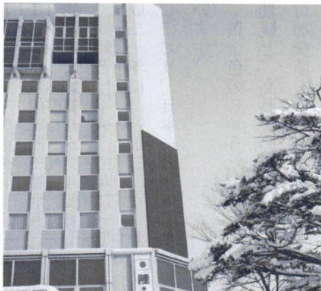
庁舎壁面に設置された太陽光パネル
