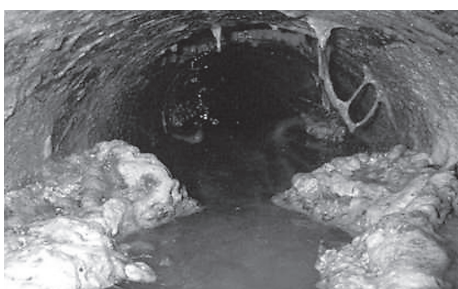
固まった油がたまった下水道管の写真
