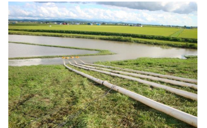
大雨時の排水ポンプ稼働状況
