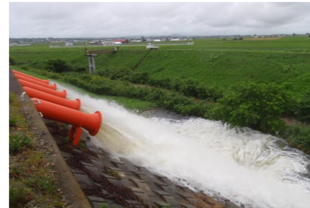
江部乙救急排水稼働状況
